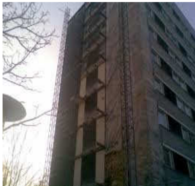
Saneeraus: Lämpötilan- ja kosteuden valvonta, Kuivaimien ja tuulettimien ohjaus
